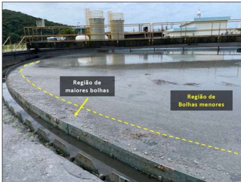
Foto 11: Poluição odorífera no Decantador 01 evidenciada pela liberação de biogás – 25/01/2022.
