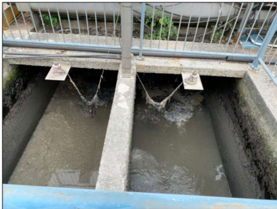
Foto 02: Resíduos sólidos existentes a jusante do gradeamento grosso (25/01/2022).
