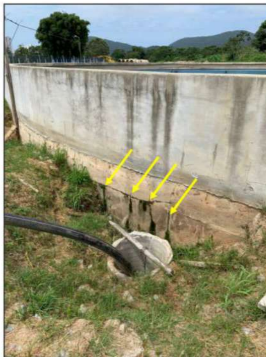
Foto 13: Vazamentos no Decantador 03 e estrutura possivelmente utilizada para captar o efluente vazado (25/01/2022).
