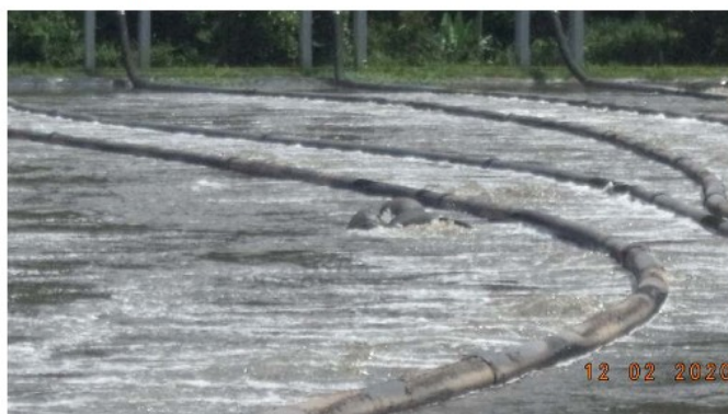
Foto 19: Problemas com difusores no tanque aerado.
