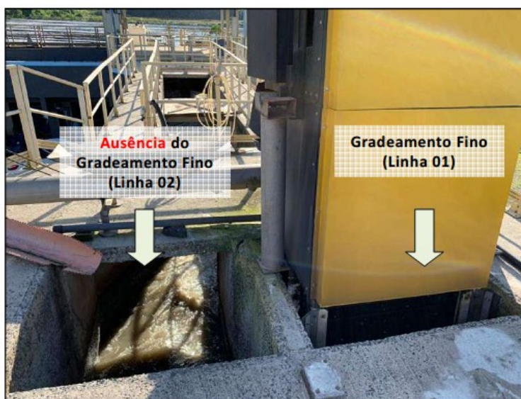
Foto 04: Ausência de gradeamento fino na Linha 02 (esquerda) de tratamento (26/04/2021).
