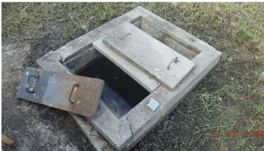
Foto 02: Caixa de passagem do clarificado da caixa de espuma contendo trincas e vazamento.
