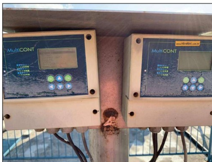
Foto 05: Medidores de nível inoperantes (26/04/2021).
