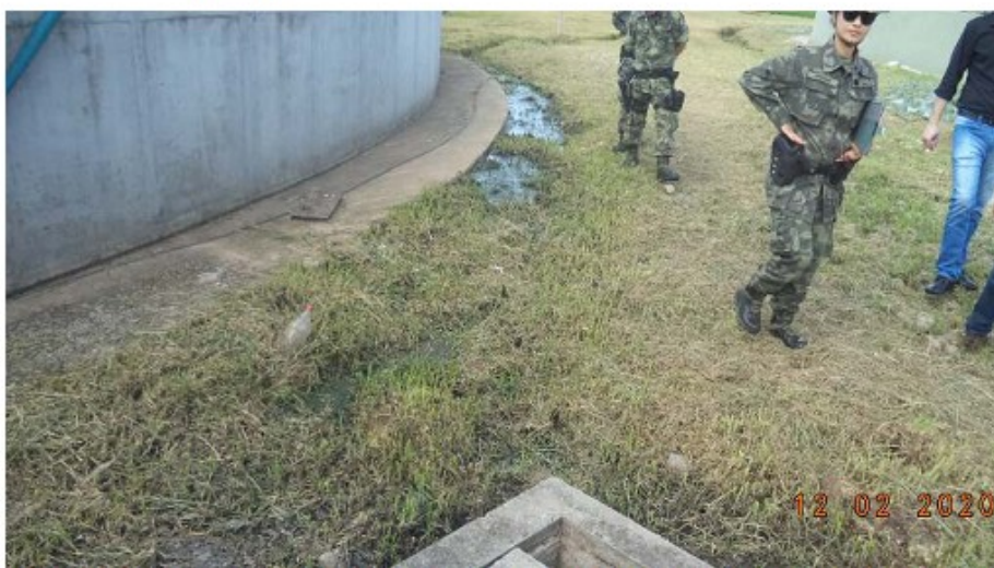
Foto 03: Visada para jusante do vazamento oriundo da caixa de passagem indicada na Foto 02.
