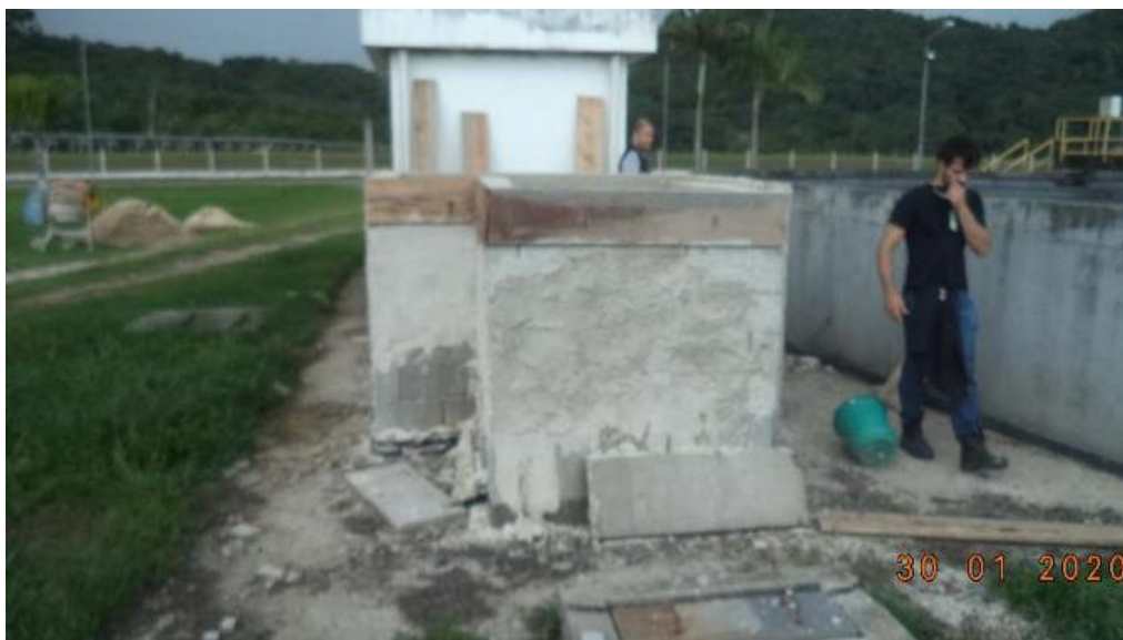
Foto 01: Situação da caixa de espuma no dia 30/01/2020.
