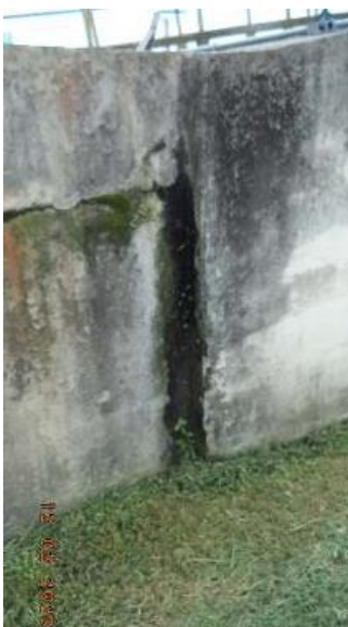
Foto 17: Vazamento de efluente na Caixa de Distribuição situada entre a Caixa de Gordura e o Tanque Aerado.
