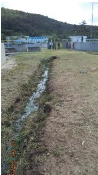
Foto 04: Visada para montante do vazamento da caixa de passagem escoando por vala escavada diretamente no solo.
