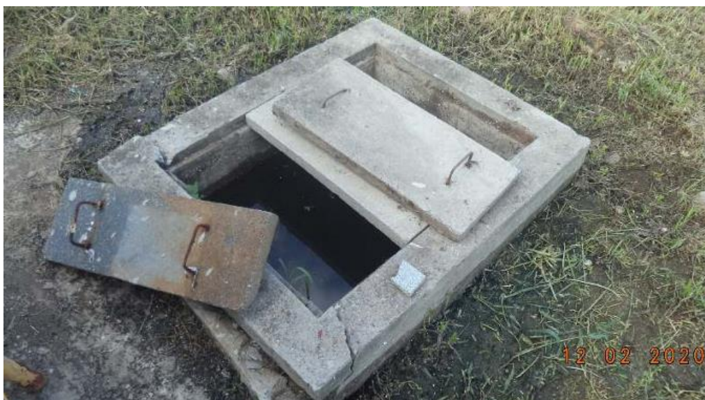
Foto 02: Caixa de passagem do clarificado da caixa de espuma contendo trincas e vazamento.
