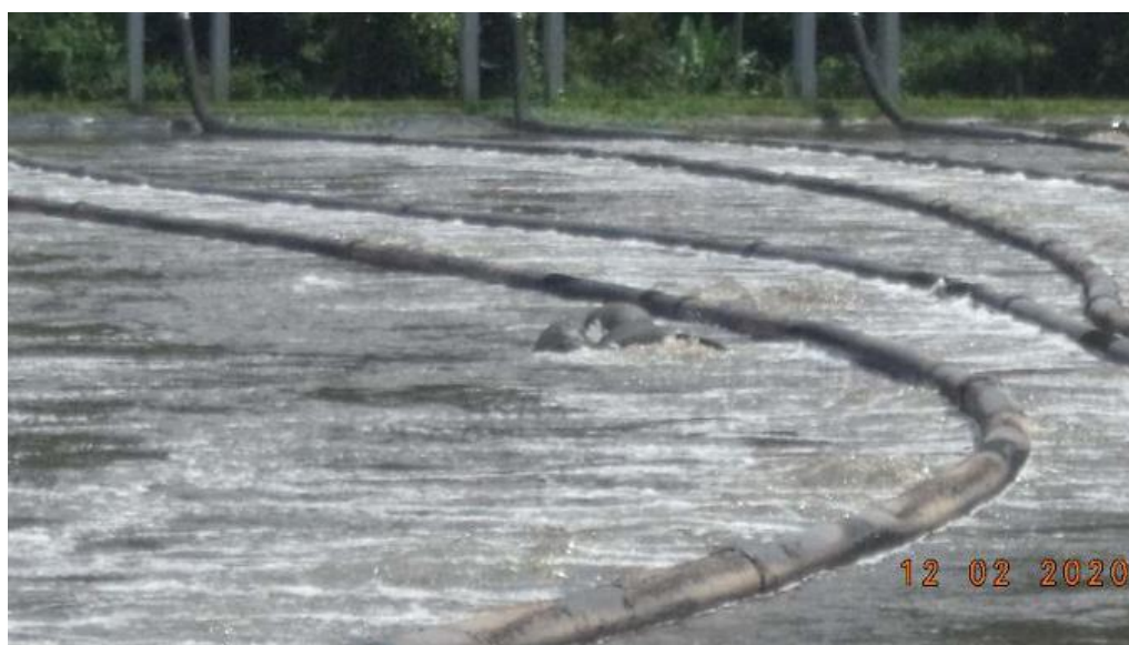
Foto 19: Problemas com difusores no tanque aerado.
