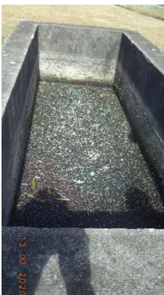
Foto 16: Acúmulo excessivo de materiais flutuantes na caixa de passagem que recebe os efluente dos Decantadores.
