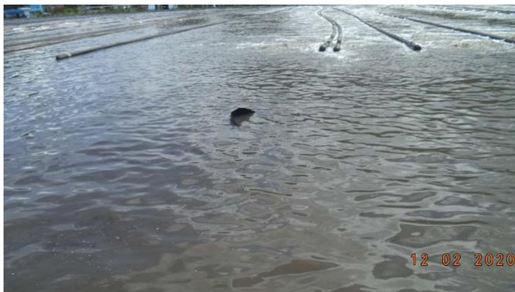
Foto 18: Geomembrana provavelmente rompida do fundo do tanque aerado, e que aflorou na data da vistoria.
