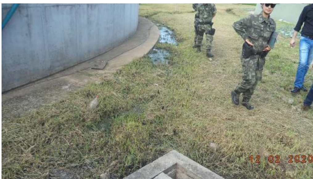
Foto 03: Visada para jusante do vazamento oriundo da caixa de passagem indicada na Foto 02.
